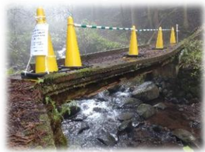
修繕前のたゆんだ橋
